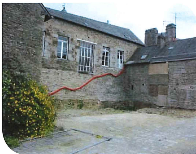
Vue arrière du bâtiment après démolition (emplacement de la future salle de réunions).
